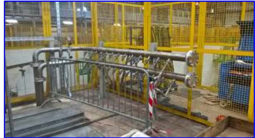
EHN1 – nuovo impianto di distribuzione
